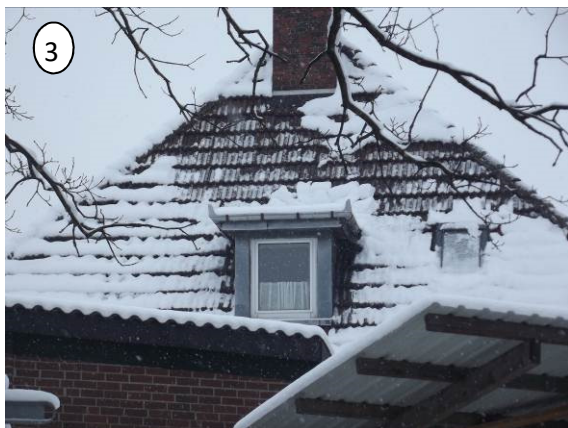
Schlecht gedämmtes nicht abgedichtetes Dach
