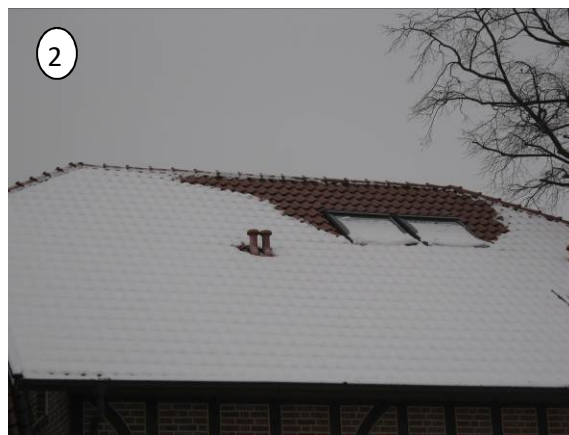
gedämmtes aber an den Dachfenstern noch nicht Luftdicht ausgebildete Konstruktion! = Konvektion
